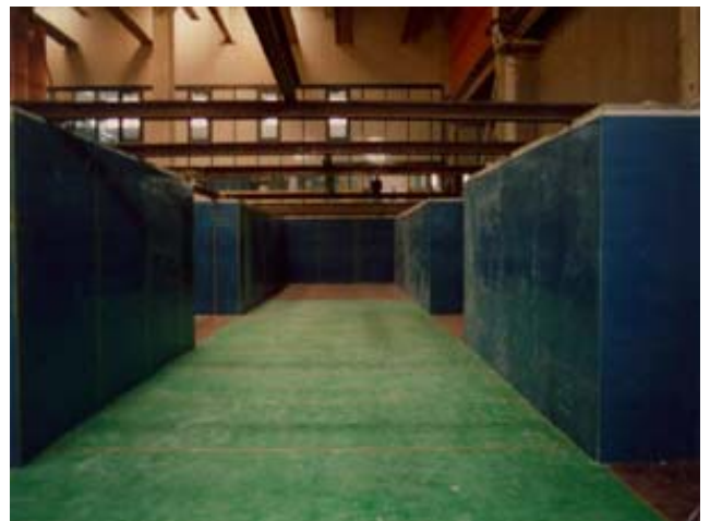
Das Bild zeigt den Einbau der horizontalen und vertikalen Matten für ein Maschinenfundament in Bologna.
